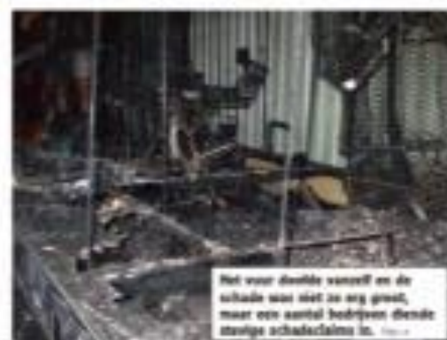
De brand brak uit na de stoet in 2004, toen de praalwagen af gestald stond in de loods. De oorzaak: wellicht een oververhitte tractormotor. ANNA KROMWOUT
